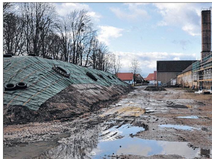
2500 Kubikmeter Aushub vom Kanalbau türmt sich auf der Rückseite des Gebäudes. Das Erdreich soll Verwendung bei der Gestaltung der Außenanlagen finden.
